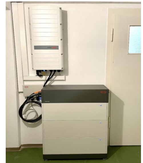
Wechselrichter und Batterie Quelle: SolarScouts Möhringen
